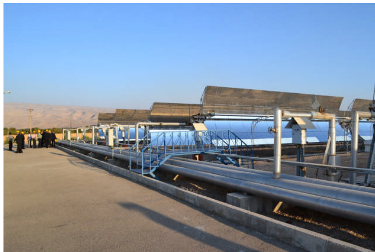
Die Solaranlage in Shiraz
